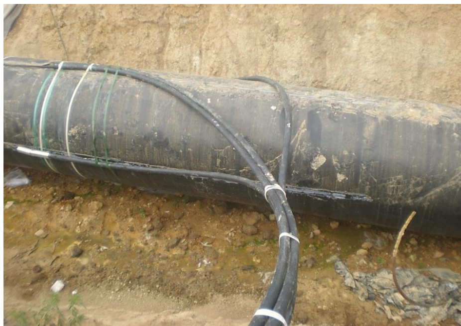
Рисунок 1.7 – Размещение волоконно-оптических датчиков на участке газопровода «Сахалин – Хабаровск – Владивосток» [39]
