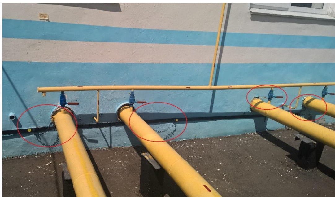
Рисунок 4.11 – Контур защитного заземления оборудования, выполненный в виде стальной полосы
