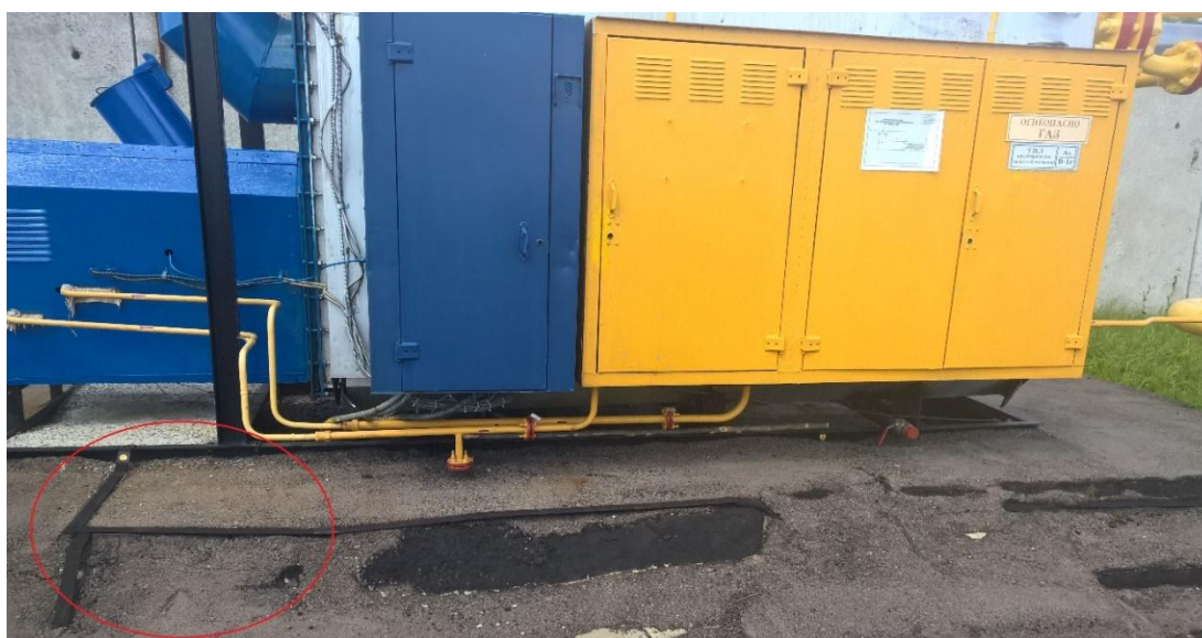
Рисунок 4.12 – Пример неразъемного соединения контура защитного заземления оборудования с общим контуром защитного заземления площадки ГРС
