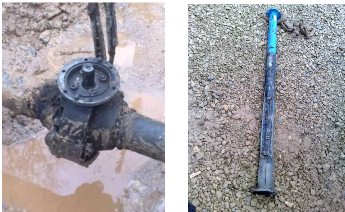
Рисунок 1.4. Последствия нагрева крана байпасной линии DN100 и удлинительной колонны кранового узла ГМ-65 в Нюксенском ЛПУ МГ [24]
