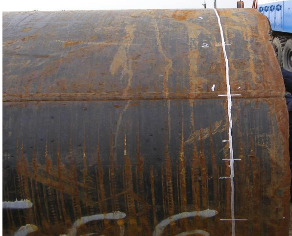
Рисунок 2.2 – Труба с нанесенным контрольным сечением I и контрольная точка 1 на продольном сварном шве (ПСШ)
