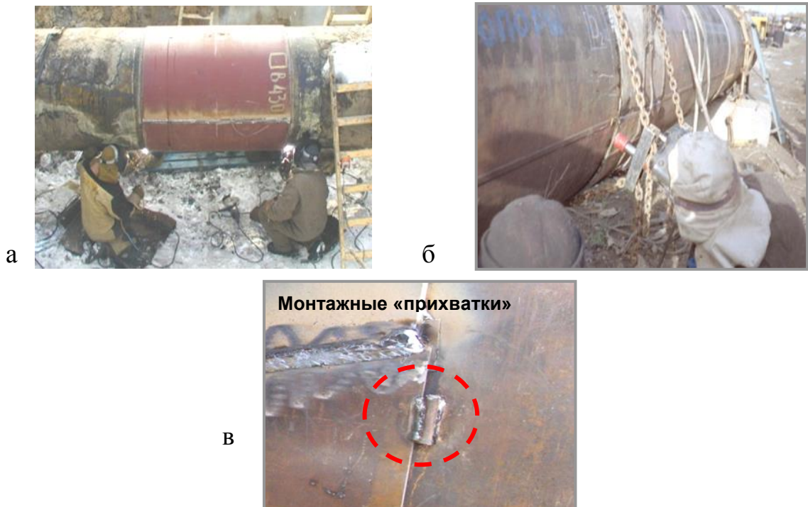
Рисунок 5.15 – Рабочие моменты установки стальной приварной муфты: а – прихватка полумуфт; б – обжим полумуфт цепными натяжителями; в – монтажные «прихватки»
