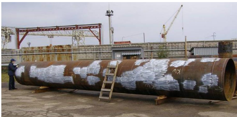
Рисунок 2.1 – Общий вид трубы № 12991 из IV нитки
