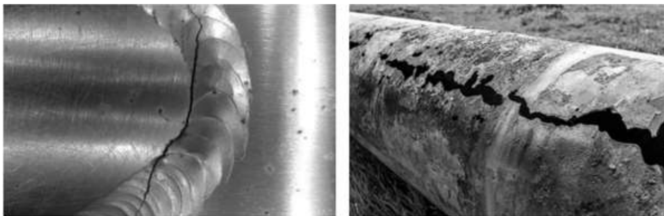
Рисунок 1 – Виды разрушений трубопроводов: дефект сварного шва (слева), коррозионное разрушение (справа).
