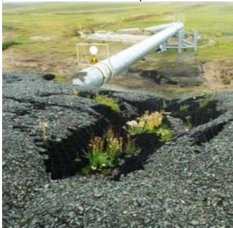
Рис. 2 – Осаждение грунта, вызванный эрозией грунтового основания
