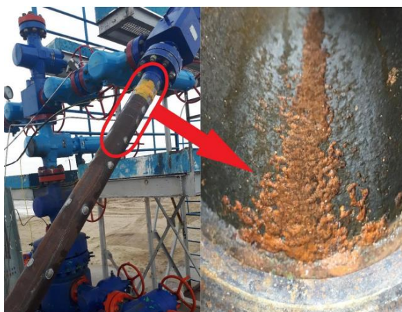
Рис. 2 – Участок трубопровода после УРД и следы коррозии по нижней образующей после двух лет эксплуатации (УРД был открыт на 10-20 %)
