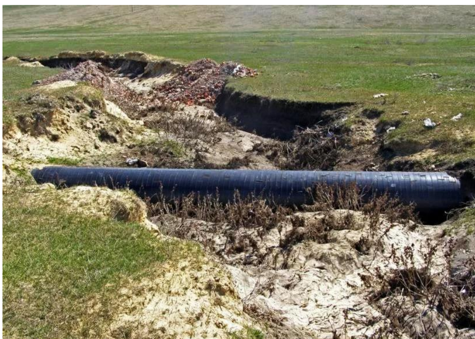
Рис. 1 – Эрозия зоны почвенного слоя, прилегающего к трубопроводу
